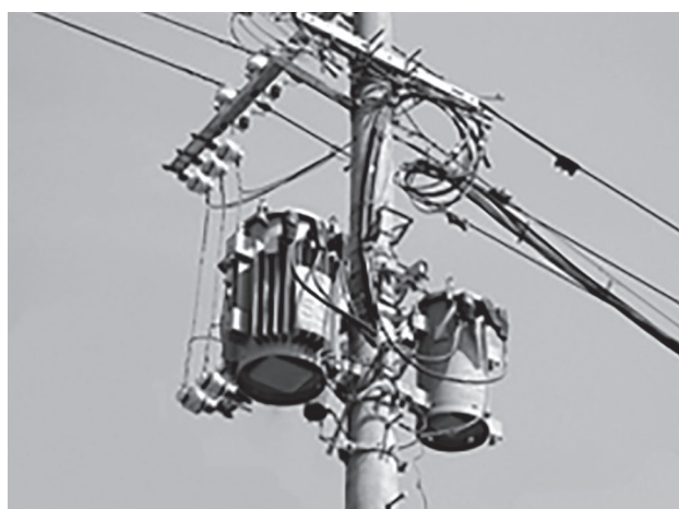
写真1 柱上変圧器の例
