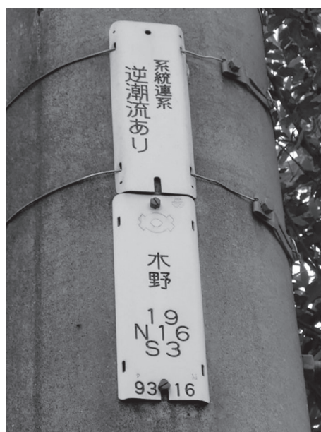
写真2 電柱に逆潮流の表示
