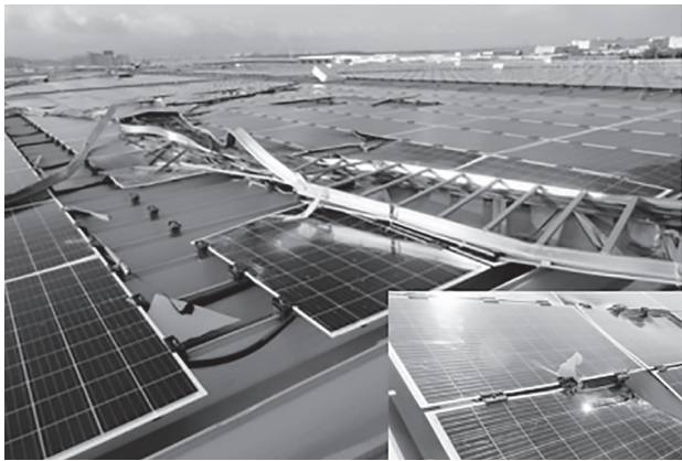
写真1 強風で建屋屋上のパネル損壊・発火 5)
