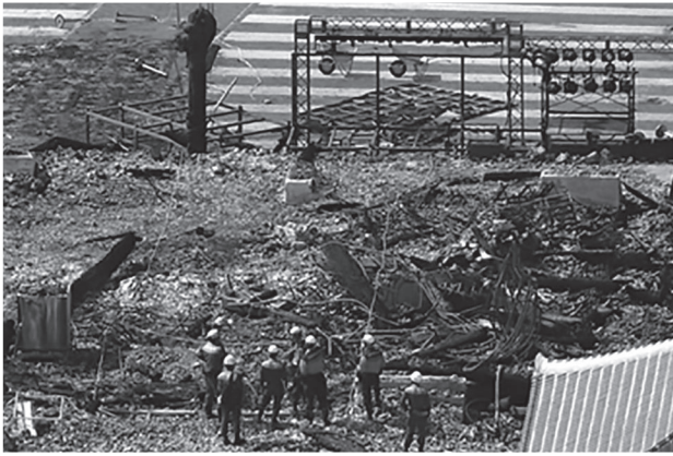
写真2 火災後に残った夜間照明の槽（北側）
