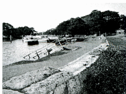
防潮堤上部の剥がれた化粧板
