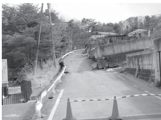
仙台市折立団地の被害状況
