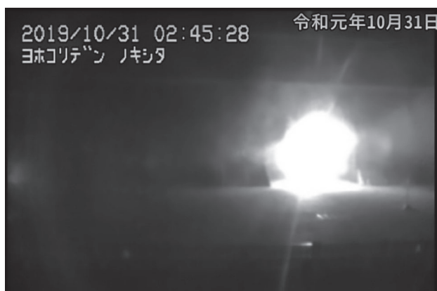
写真5 分電盤室で捉えられたフラッシュ光
