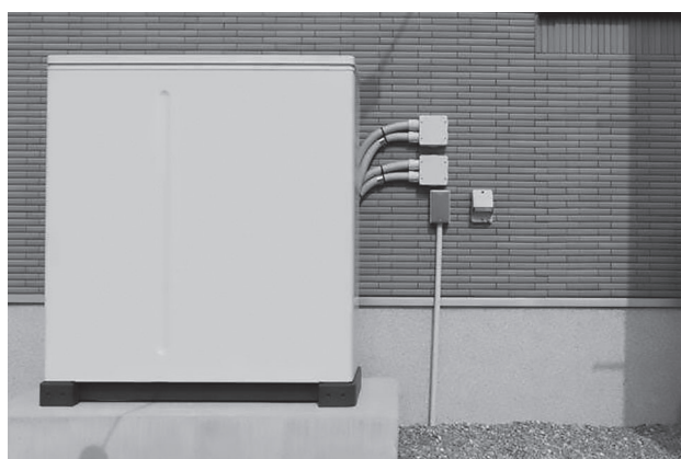
写真5 家庭用蓄電池の事例
