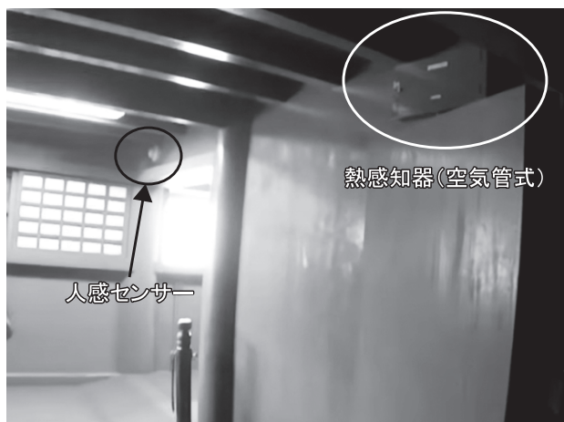
写真4 親子扉上部に設置されて温度センサー 3)
