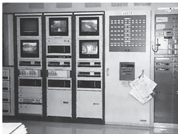
写真5 奉神門に設置されている監視盤 1)
