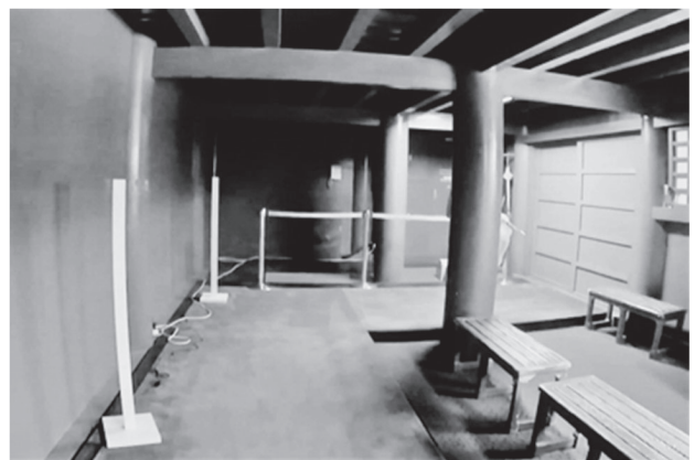
写真2 分電盤室内の様子；延長コードとLED照明 2)
