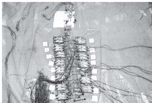
画像6 焼け跡から回収されたブレーカー
