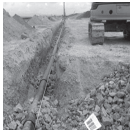
写真5 発生ガス横引き管
