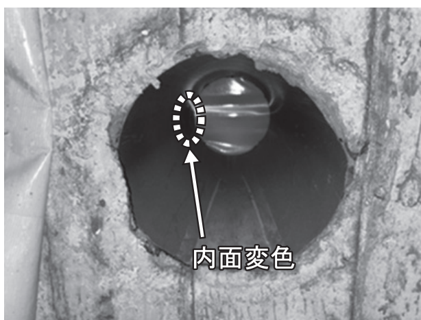
写真9 基礎梁部スリーブ損傷箇所（地下ピット部）
