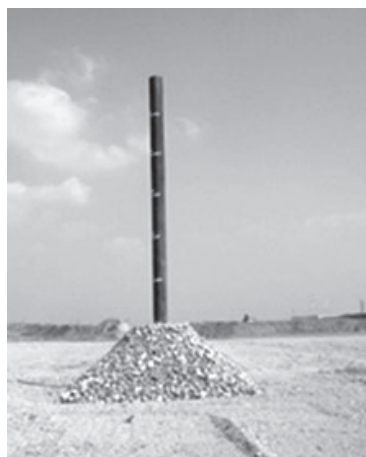
写真3 ガス抜き管（縦管）
