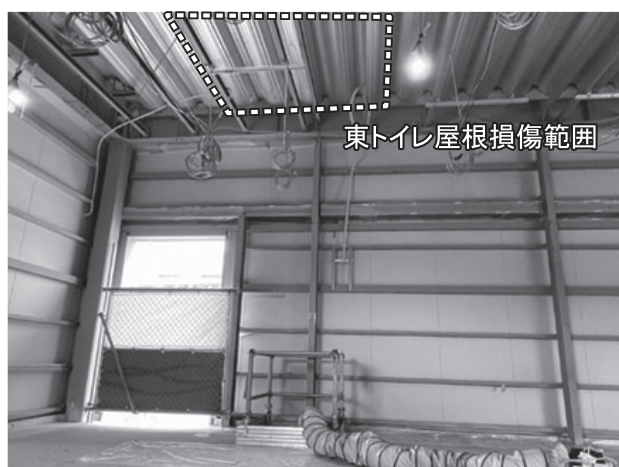
写真8 東トイレ屋根損傷箇所
