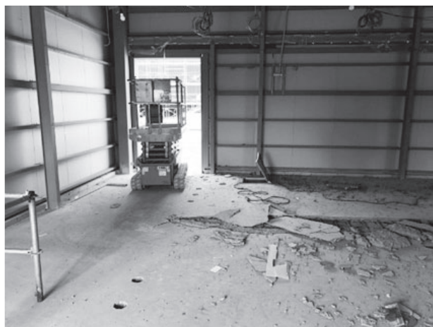
写真7 床および床点検口の破損箇所
